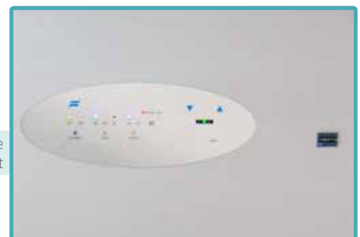
Betriebsstundenzähler zur Kontrolle der Filterstandzeit
